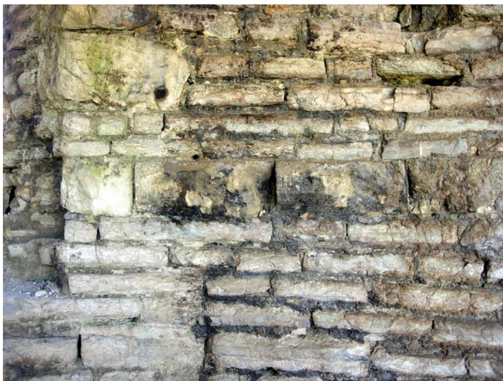
Fig. 12 Particolare della cornice in blocchi di calcarenite
