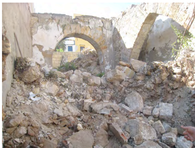
Fig. 3 Gli accumuli di macerie all'interno del fabbricato di via Pantelleria
