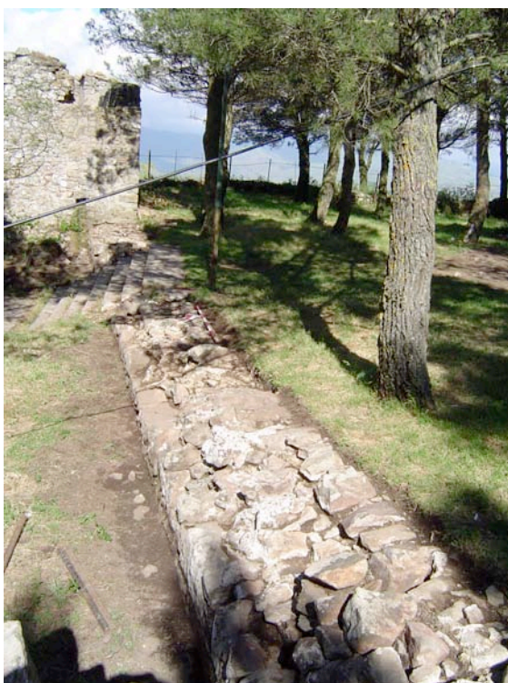
Fig. 39 Resti del muro di fortificazione esterno del versante nord presso la chiesa di S. Giacomo
