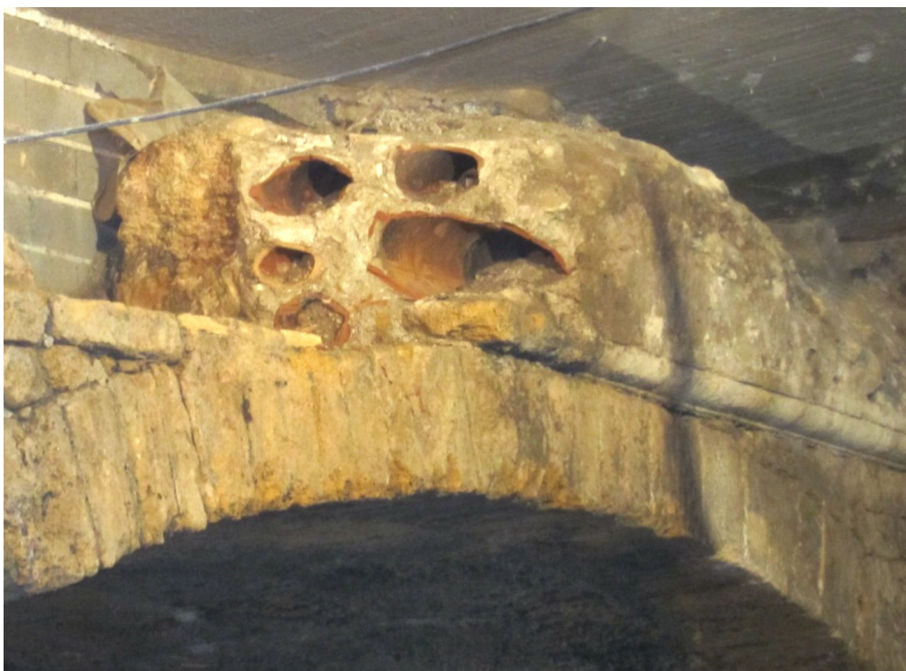
Fig. 34 Il crollo parziale del parapetto mette in mostra cinque condotte d'acqua incassate al di sotto del paramento esterno
