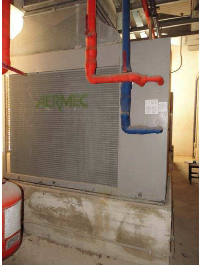
Foto 5: Vista del primo motore dell'impianto di condizionamento.
