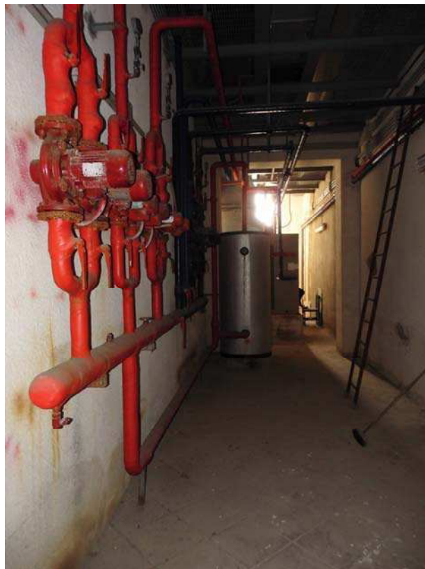
Foto 4: Vista d'insieme del locale tecnico.
