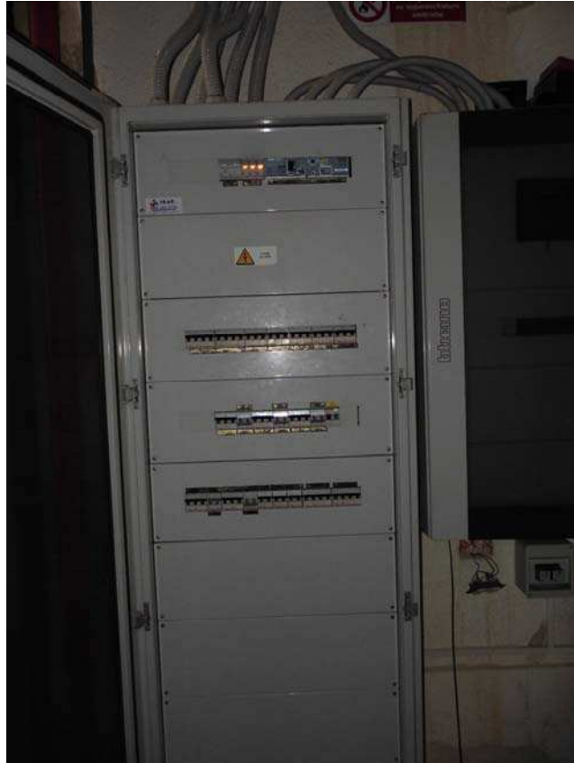
Foto 3: Vista secondo quadro elettrico.
