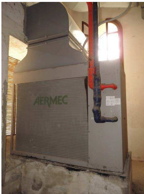
Foto 7: Vista del secondo motore dell'impianto di condizionamento.
