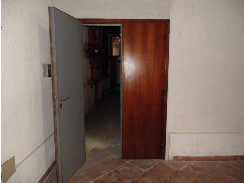
Foto 1: Vista ingresso locale tecnico.
