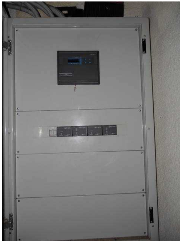
Foto 2: Vista primo quadro elettrico.
