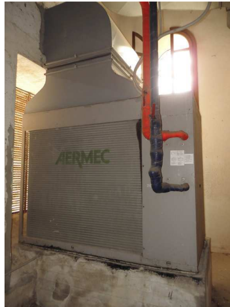
Vista di una delle due macchine per il trattamento dell'aria
