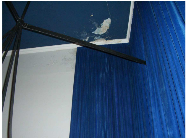
Infiltrazioni di acque piovane all'interno di sale espositive
